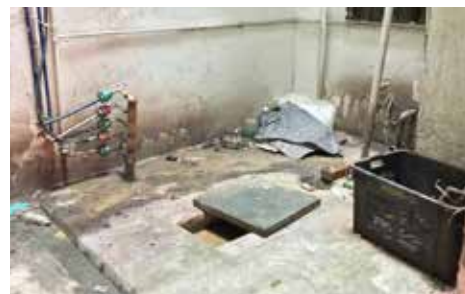
Sistem kumbahan yang rosak di Pangsapuri Taman Samudera akan dibaiki menggunakan peruntukan RM700,000 daripada KPKT.
